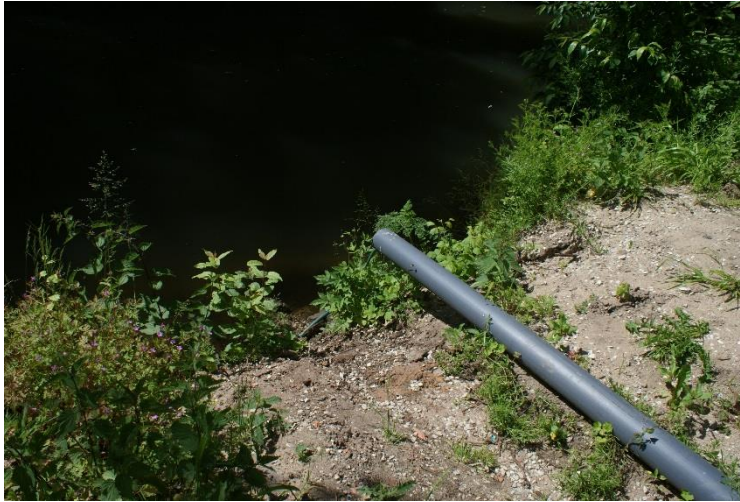
Rohrableitung des Quellaustritts in die Schwarzach
